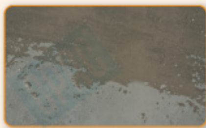
ผิวคอนกรีตที่มีการฉีกระเบิดน้ำมากเกินไป
